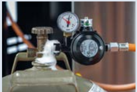
Keine Blasenbildung: Anlage ist dicht!
