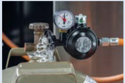
Blasenbildung: Anlage undicht!
