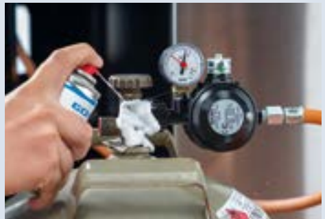
Anschlüsse mit GOK-Lecksuchspray einsprühen
