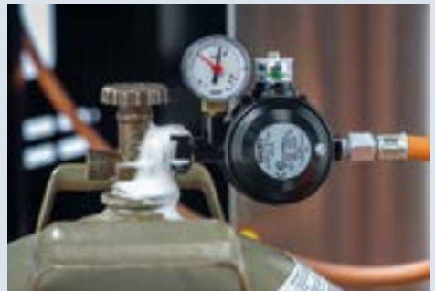
Keine Blasenbildung: Anlage ist dicht!
