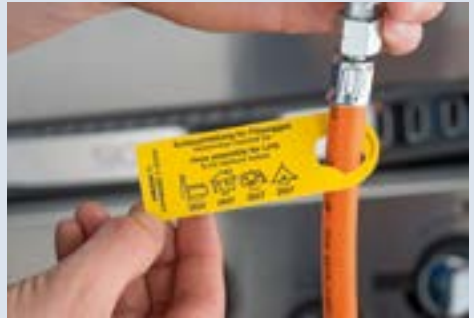
Gelber Schlauchanhänger mit dem Austauschdatum der Schlauchleitung
