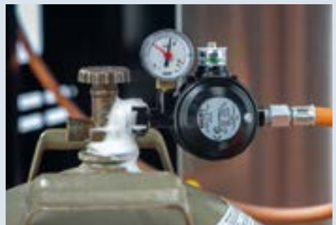
Keine Blasenbildung: Anlage ist dicht!
