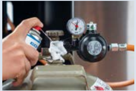
Anschlüsse mit GOK-Lecksuchspray einsprühen
