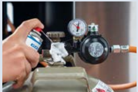
Anschlüsse mit GOK-Lecksuchspray einsprühen
